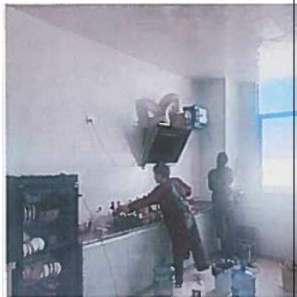
项目升压站食堂油烟净化器
